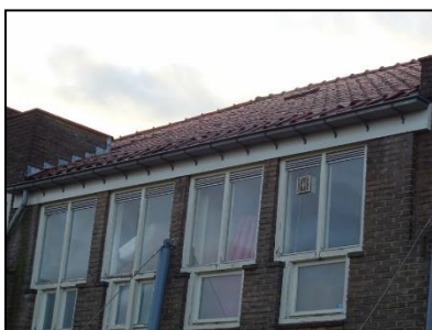
Figuur 10. Aanzicht hoofdingang kringloopwinkel vanuit het noorden met dakrand mogelijk geschikt habitat voor huismussen.
