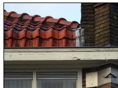
Figuur 12. Steile dakhelling oostzijde kringloopwinkel.
