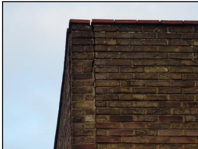
Figuur 15. Spleten in voegwerk tussen muren boven de hoofdingang van de kringloopwinkel.
