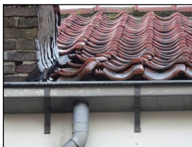
Figuur 11. Close-up van dakrand met losliggende dakpannen met mogelijk geschikt habitat voor huismussen
