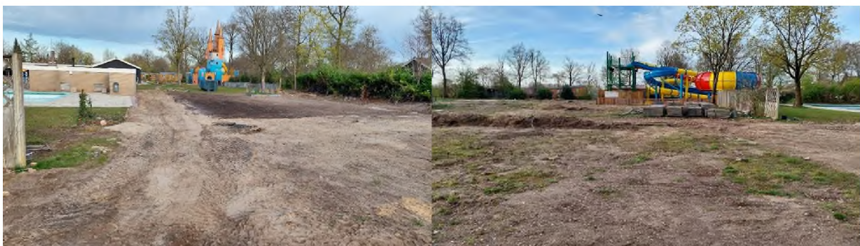
Figuur 13: Links: noordwestelijke deel van het plangebied met aan de bovenste rechterzijde de verwijderde tegelvloer van het zonneterras, gefotografeerd richting het westen. Rechts: de aangelegde waterglijbanen met op de voorgrond een openliggende leidingsleuf, gefotografeerd richting het zuiden (bron: KSP Archeologie).
