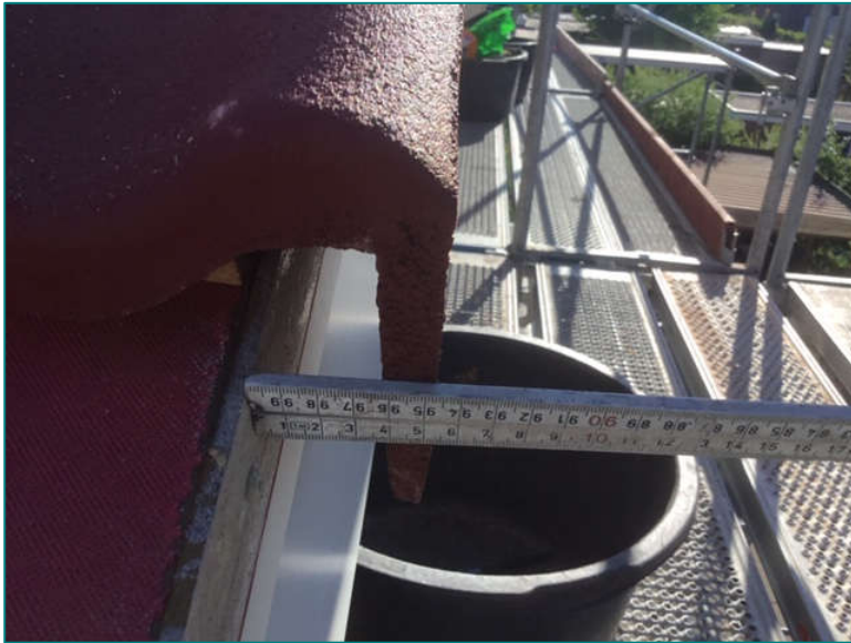
Figuur 4: afstand van 3 cm tussen boeibord en gevelpan. Hierdoor ontstaat een invliegopening en toegang tot de ruimte onder de dakpannen voor vleermuizen. Bovenste rand van het boeibord is opgeruwd.
