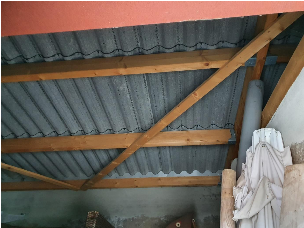
Figuur 3 Fauna werende maatregelen en missend dakbeschoot
