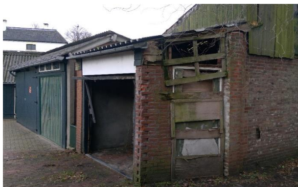
Foto: aangrenzende schuur bedekt met asbestverdachte golfplaten.
