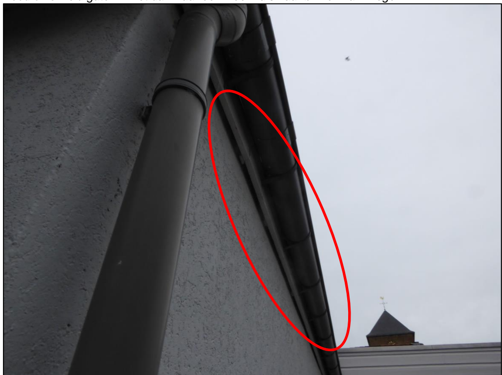
Rood omcirkeld de aanwezige kier onder de dakrand.
