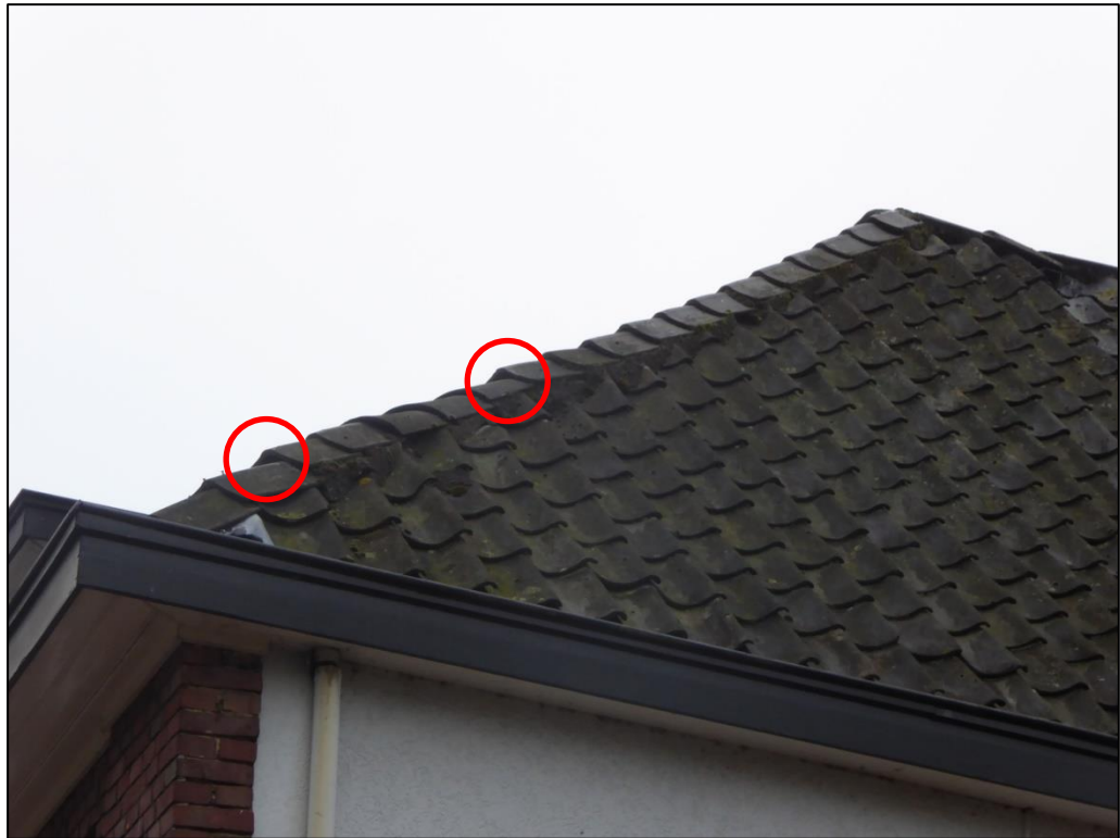
Rood omcirkeld gaten in het dak waar een vleermuis naar binnen kan vliegen.
