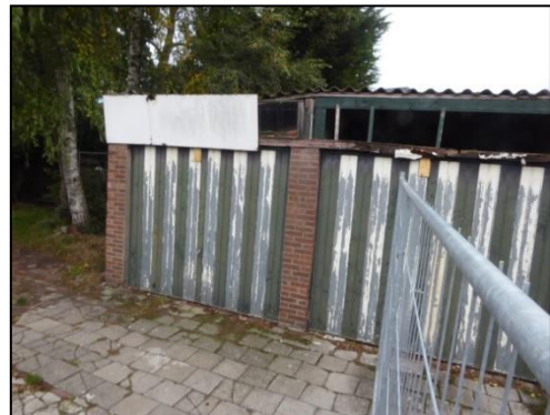
Aanwezige leegstaande garageboxen;
