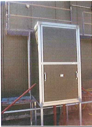
Foto: geluidwerende kast om bestaande mixer
